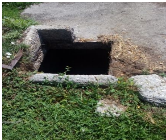
A közlekedési útvonal melletti szennyvízelvezető akna fedőlapja hiányzott
