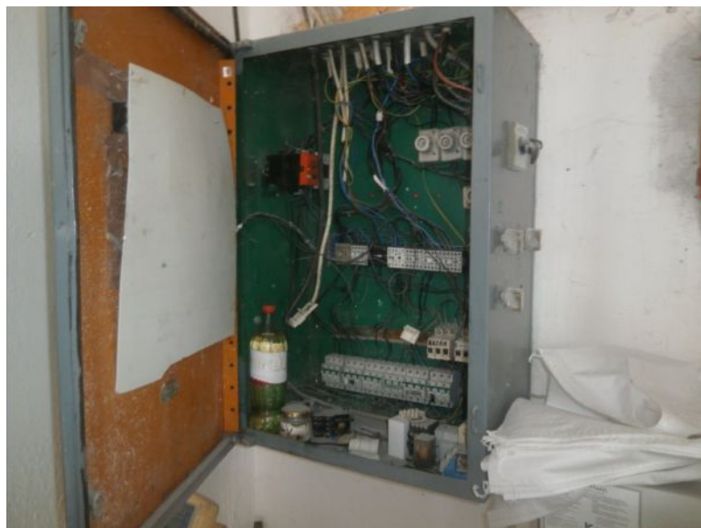
A ventilátor 400V-os villamos kapcsolószekrénye nyitott állapotban, benne üdítőitalos flakonban gyomirtó tárolása
