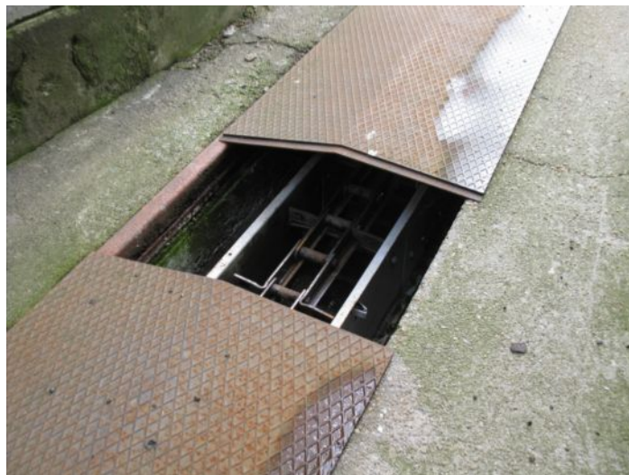
A gabonaszállító vonszolólánc aknájáról eltávolították a beton fedelet, a vonszolóláncot fedő lemezburkolat hiányos. A vonszolólánc működését villanymotor biztosította lánchajtással, amelynek a teljes védőburkolata hiányzott.
