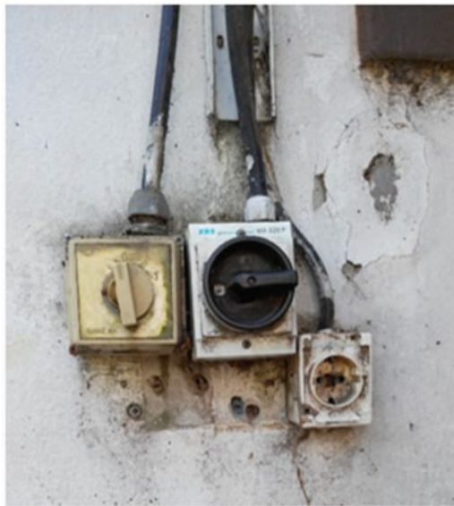
Sérült, nem megfelelő védettségű dugaszolóaljzat, kültéren
