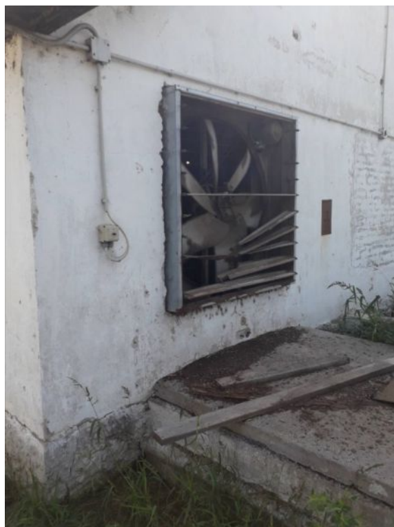
Az istálló épület végében lévő szellőztető ventilátor védőburkolata hiányzott
