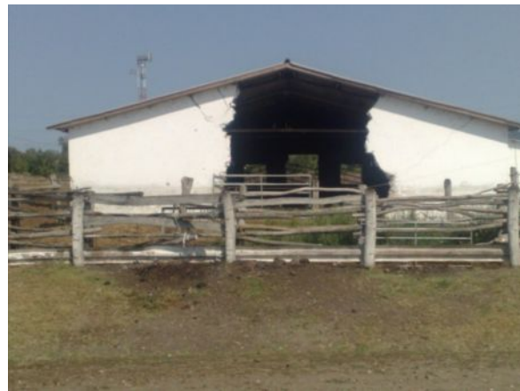
Szarvasmarha istálló nem megfelelő szilárdságú falszerkezete
