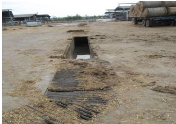
A fedetlen hígtrágya kifolyó csatorna
