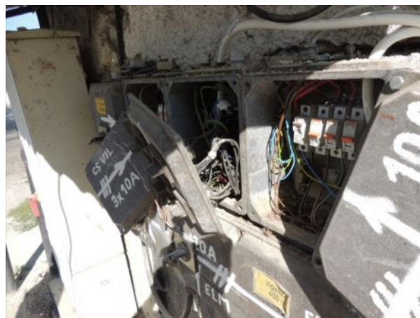
Szárító berendezés fedetlen villamos tokozatai
